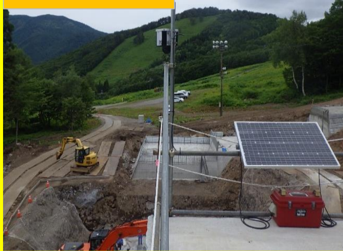
ライブカメラ設置
