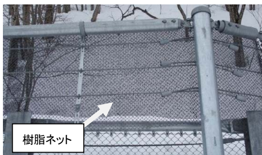
写真6 表層雪崩すり抜け防止ネット (山形自動車道 仁田山トンネル坑口付近)
