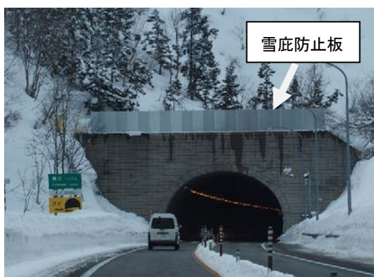
写真5 道路側に傾斜をつけた雪庇防止板 (秋田自動車道 黒沢トンネル坑口)
