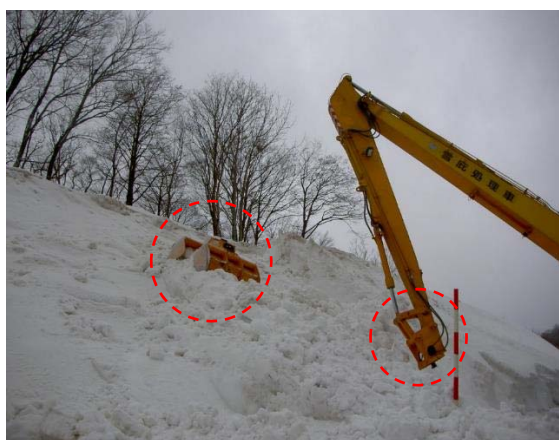
写真2 作業中バケットが外れた状況
