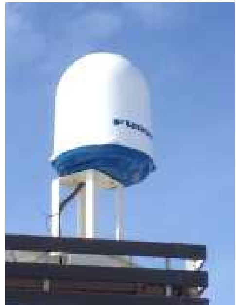
図2 小型気象レーダの設置状況
