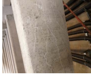
【写真4 支柱部のクラック】
