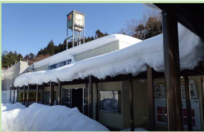
■写真-1 (休憩施設雪庇発生状況)
