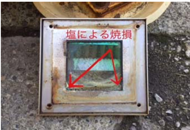
写真8. 塩害によるヒーター熱線ショート
