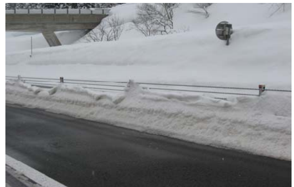
写真-3 WR部堆雪状況
