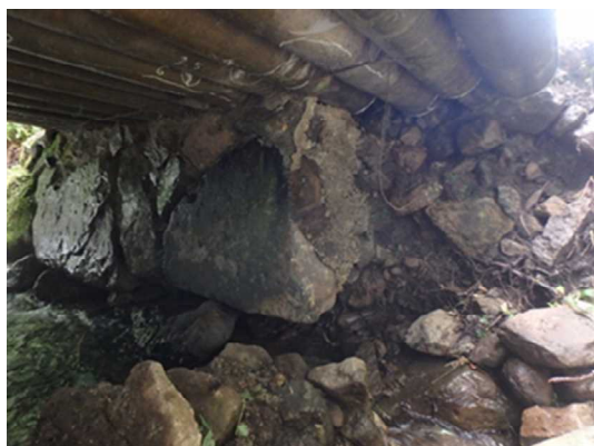
写真4-14 【損傷】橋台の欠損
