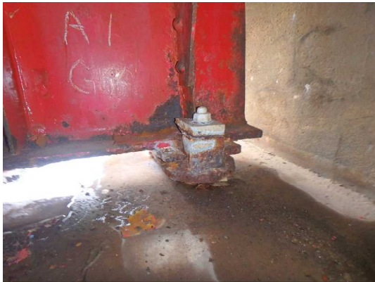
写真4-8 【損傷】 沓座モルタルの欠損
