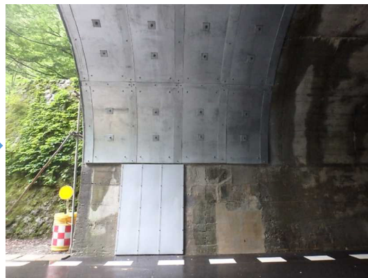
写真 4-21 【対策】覆工修復工、 覆工背面充填、ロックボルト補修、 鋼板設置
