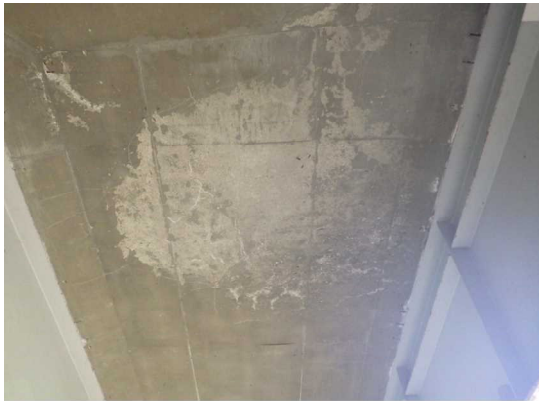
写真4-2 【損傷】床版ひびわれ
