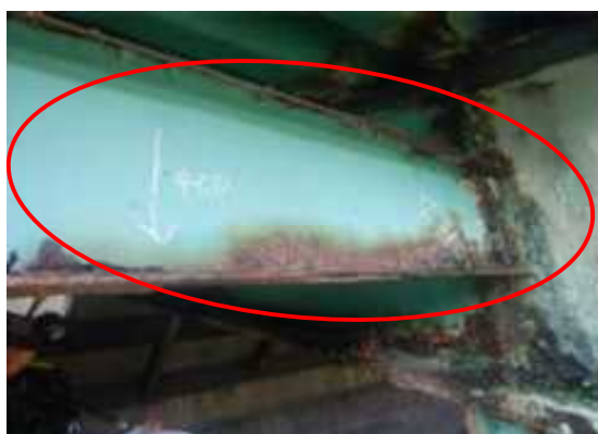
写真 4-23 【損傷】横梁の変形・欠損
