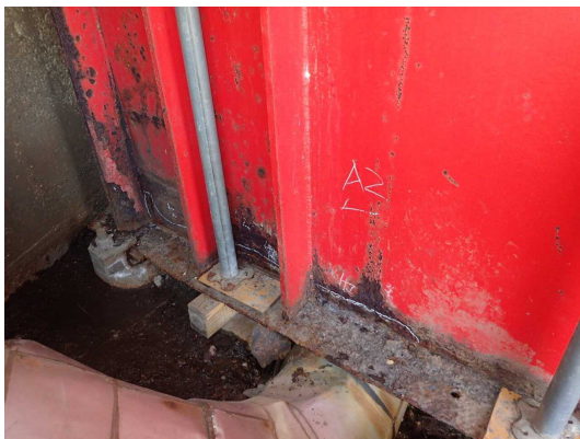
写真4-5 【損傷】 主桁の腐食、変形・欠損
