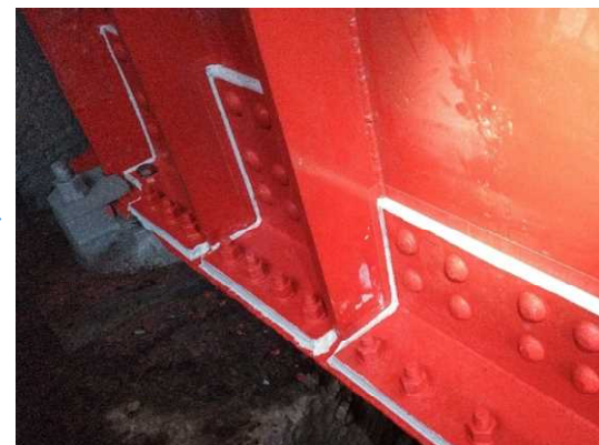
写真4-6 【対策】主桁のあて板補修 （塗替え塗装）
