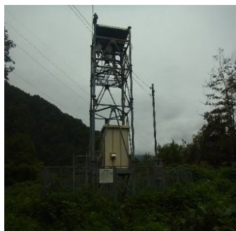
放流警報施設
