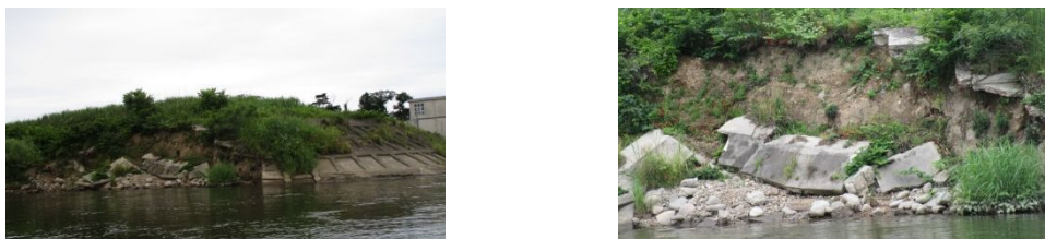
河岸崩壊の状況
