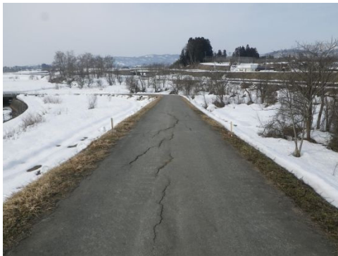
堤防の天端舗装補修前の状況
