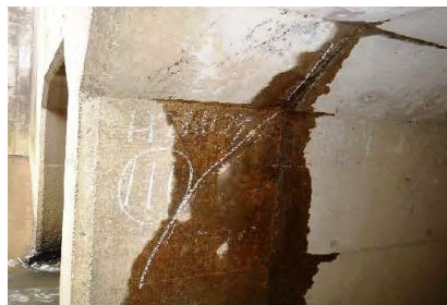
樋管・樋門の漏水状況
