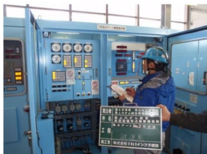
ゲート設備点検
