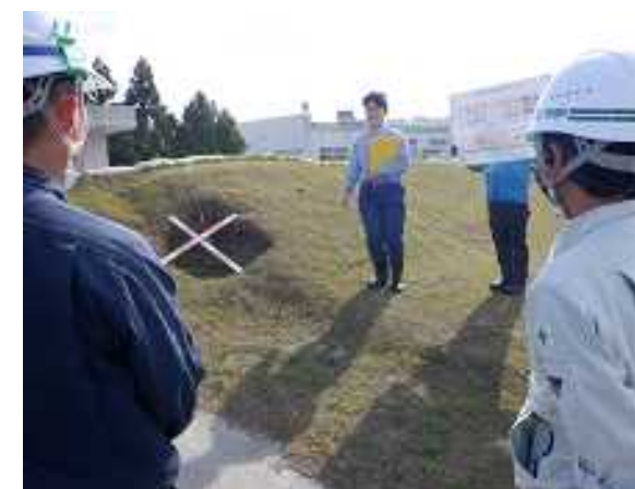
堤防の陥没の計測
