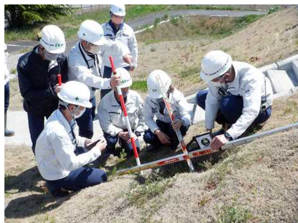
堤防法面の陥没の計測
