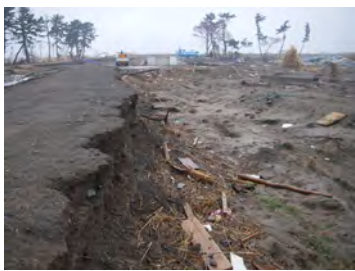
被災状況 (河口から左岸 0.0k 付近、 仙台市若林区藤塚地先)
