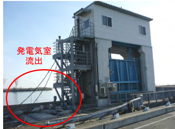
閉上水門(被災後)
