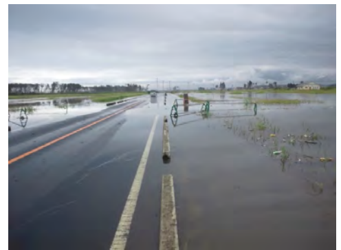
台風15号(平成23年9月)による浸水状況(仙台市若林区井土地先)
