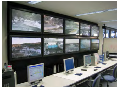
ダム放流設備制御装置
