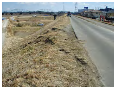
車両による堤防損傷
