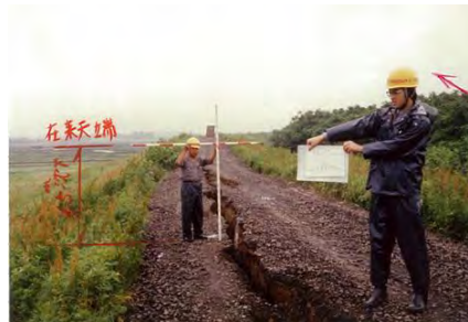
堤防の亀裂・沈下
