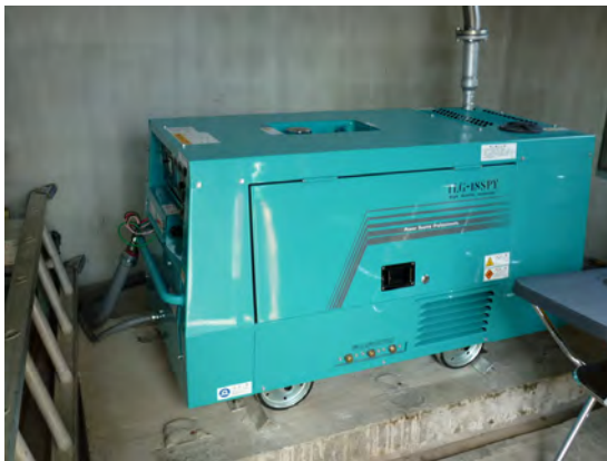
発電機設置状況(地震前)
