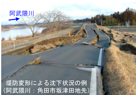
東北地方太平洋沖地震による堤防被災事例
