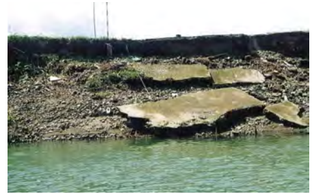
河岸崩壊の状況 名取川 5.0km 付近（平成 11 年 8 月洪水）
