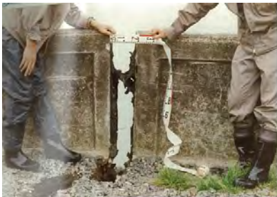
関上特殊堤接合部の開口
