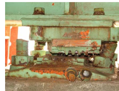
▲ 支承の損傷(ローラー支承)
