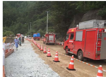
緊急車両通行状況（9/6）
