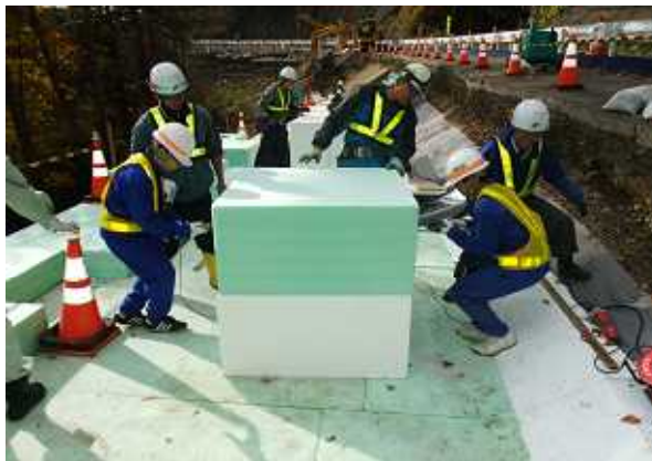
登坂車線工事で発泡スチロールを 積む作業を体験しました
