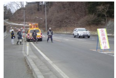
通行止めの状況
