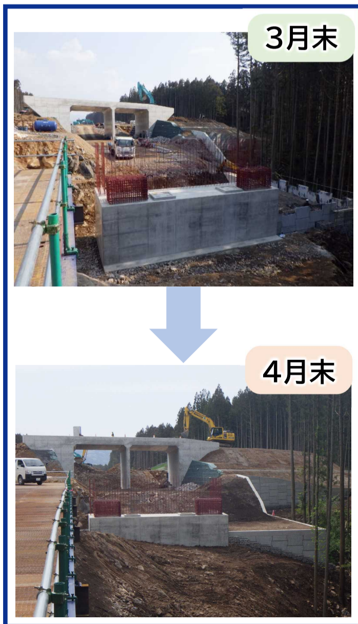
てらやしき 写真② 寺屋敷地区 ぬのくら (仮称)布倉橋 下部工工事状況
