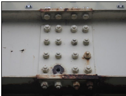
[横断歩道橋のボルトの脱落]
