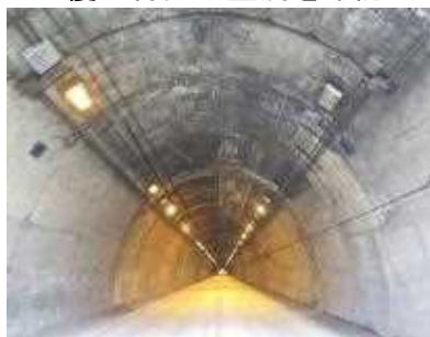
【変状③】 覆工背面に空洞を確認
