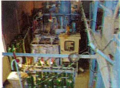
《濁水プラント設備》
