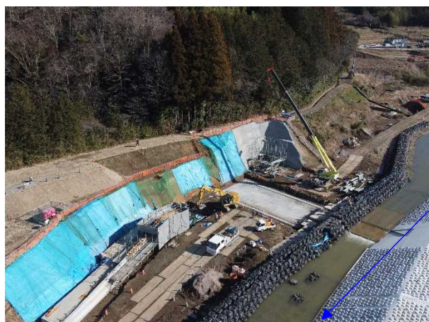
⑩内川流域堰ゲート設備災害復旧工事 埋設作業状況(山下堰)
