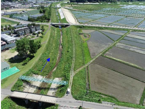
⑬阿武隈川水系内川流域築堤外(その5)工事 新川 河川土工 着手前 〈泉橋下流〉
