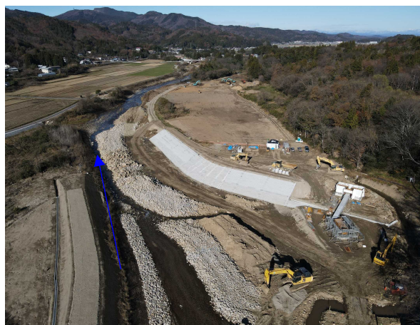
⑪阿武隈川水系内川流域築堤外(その3) 工事 内川 法覆護岸工・導水路工 施工中 〈矢田橋上流〉
