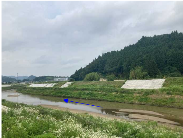
⑦内川流域災害復旧施設外（その2）工事 樋管④ 樋管本体工 着手前 〈内川橋下流〉
