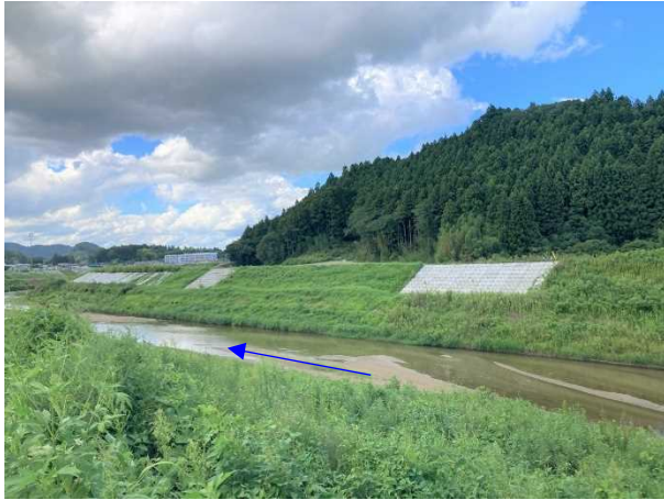
⑦内川流域災害復旧施設外（その2）工事 樋管④ 樋管本体工 着手前 〈内川橋下流〉
