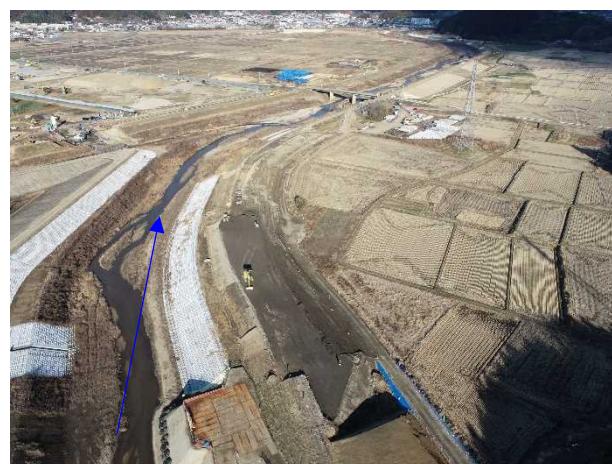
⑯阿武隈川水系内川流域築堤外(その8)工事 内川 河川土工 施工中 〈内川橋上流〉
