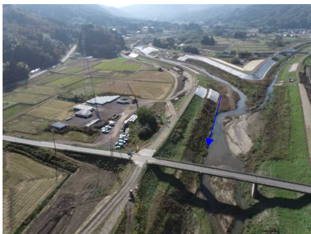
⑯阿武隈川水系内川流域築堤外(その8)工事 内川 河川土工 施工中 〈内川橋上流〉
