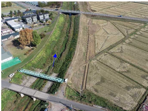
⑬阿武隈川水系内川流域築堤外(その5)工事 新川 河川土工 着手前 〈泉橋下流〉
