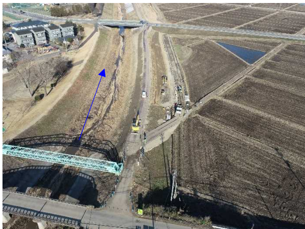
⑬阿武隈川水系内川流域築堤外(その5)工事 新川 河川土工 施工中 〈泉橋下流〉
