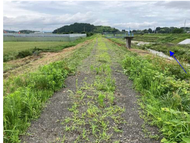
⑧内川流域災害復旧施設外（その3）工事 樋管⑧ 樋管本体工 着手前 〈内川橋上流〉
