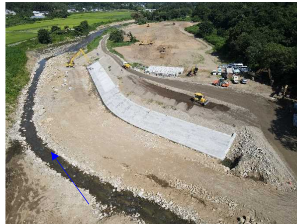
⑪阿武隈川水系内川流域築堤外（その3）工事 内川 法覆護岸工 施工中 〈矢田橋上流〉
