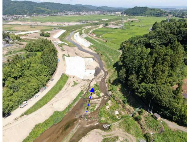
②内川流域山下堰（右岸）工事 山下堰(右岸) 可動堰本體工 着手前 〈大目橋下流〉
