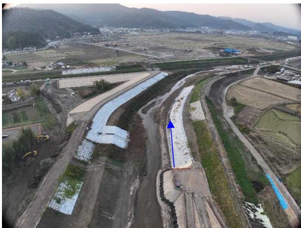
①阿武隈川水系内川流域築堤外工事 内川 河川土工 施工完了 〈大目橋下流〉
