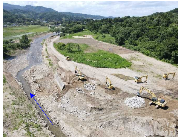
⑪阿武隈川水系内川流域築堤外(その3)工事 内川 構造物撤去工 施工中 〈矢田橋上流〉
