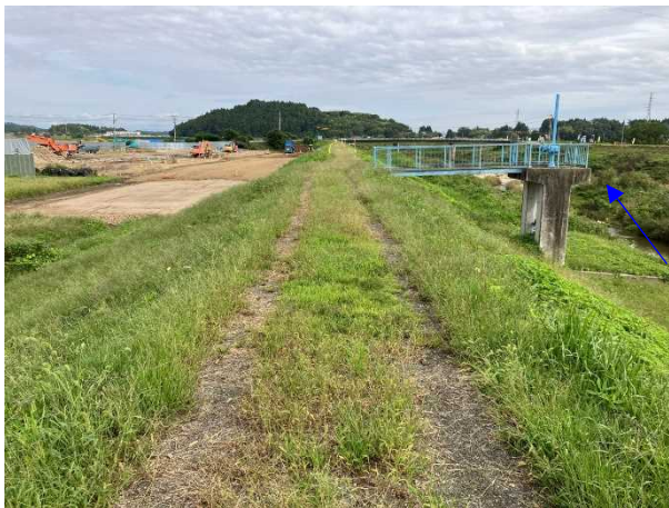
⑧内川流域災害復旧施設外(その3)工事 樋管⑧ 樋管本体工 着手前 〈内川橋上流〉
