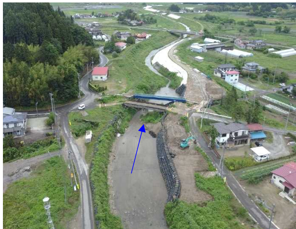
④内川流域橋梁下部工工事 旧五福谷橋 旧橋撤去工 着手前 〈旧五福谷橋上流〉
