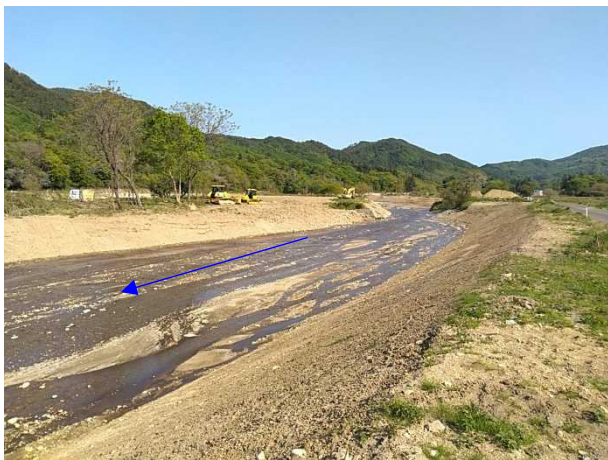
④内川流域橋梁下部工工事 下矢田橋 橋台工 着手前 〈矢田橋上流〉
