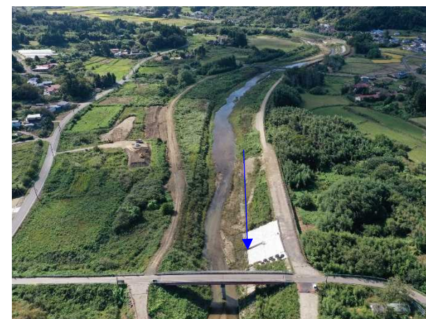
⑱阿武隈川水系内川流域築堤外(その10)工事 樋管⑩ 樋管本體工 着手前 〈大目橋上流〉
