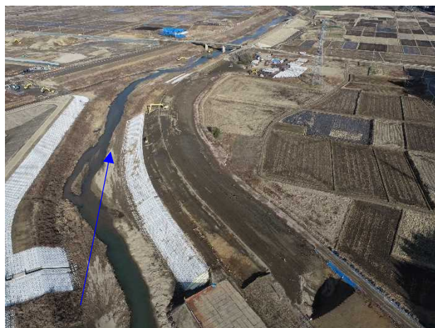
⑯阿武隈川水系内川流域築堤外(その8)工事 内川 河川土工 施工中 〈内川橋上流〉
