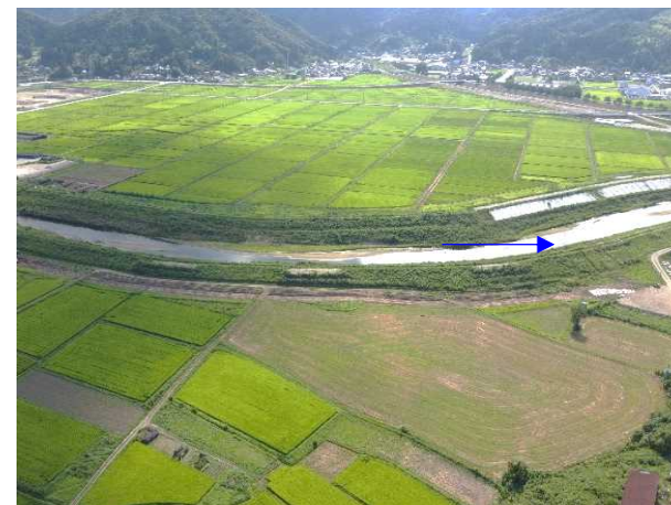
⑮阿武隈川水系内川流域築堤外(その7)工事 内川 着手前 〈内川・阿武隈川合流点〉
