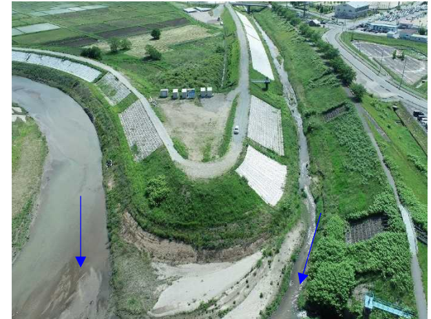
⑨内川流域災害復旧施設外(その4)工事 樋管③ 樋管本体工 着手前 〈内川・新川合流点〉
