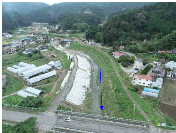
⑰阿武隈川水系内川流域築堤外(その9)工事 五福谷川 仮設工 施工中 〈五福谷橋上流〉
