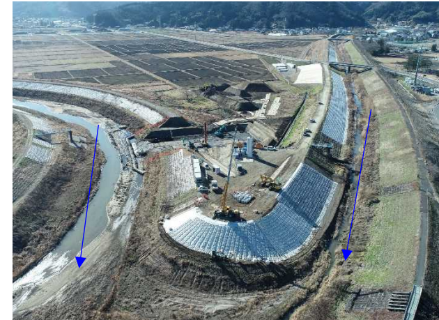
⑨内川流域災害復旧施設外(その4)工事 樋管③ 樋管本体工 施工中 〈内川・新川合流点〉
