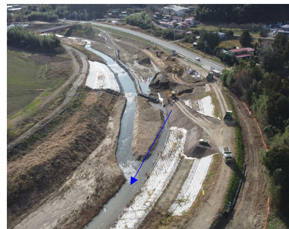
③内川流域和田堰（左岸）工事 和田堰(左岸) 構造物撤去工 施工中 〈和田橋下流〉
