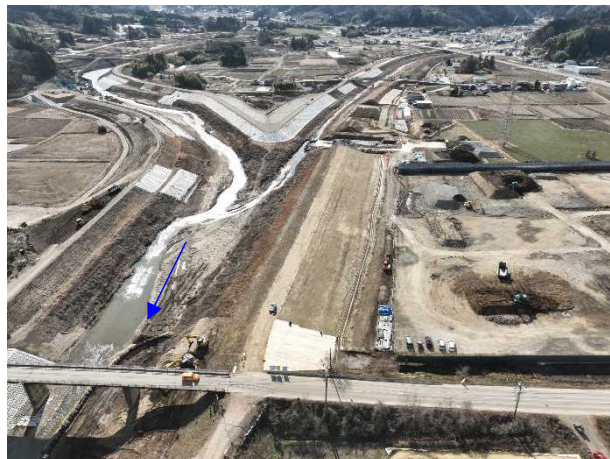
⑭阿武隈川水系内川流域築堤外(その6)工事 内川 河川土工 施工中 〈内川橋上流〉
