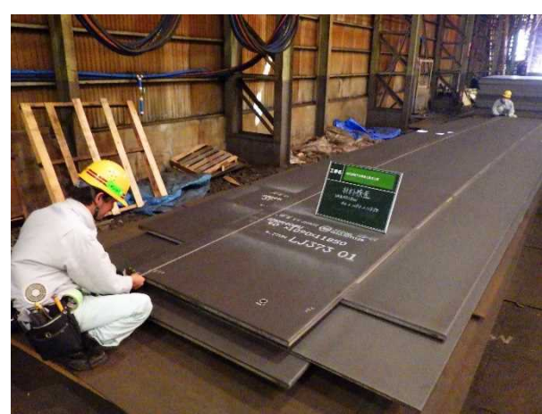
⑥内川流域下矢田橋上部工工事 下矢田橋 鋼橋架設工 材料確認中 〈矢田橋上流〉
