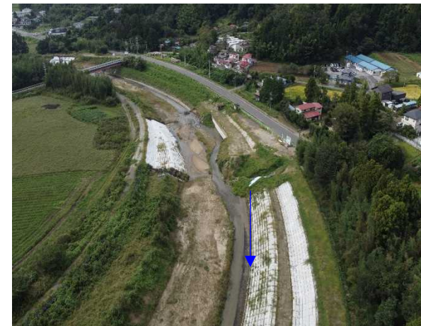
③内川流域和田堰（左岸）工事 和田堰(左岸) 可動堰本体工 着手前 〈和田橋下流〉
