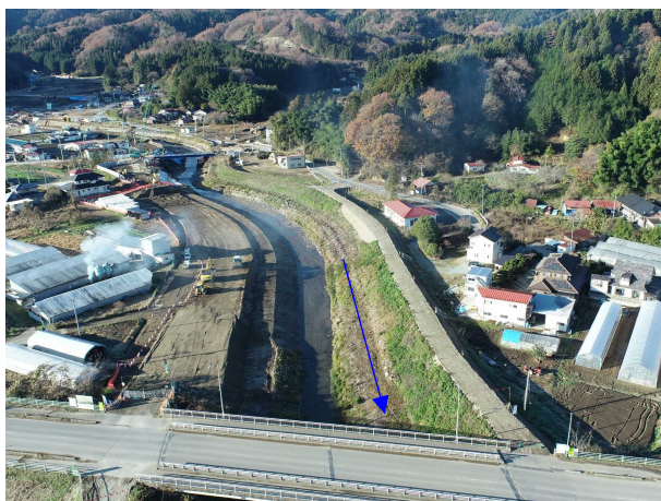
⑰阿武隈川水系内川流域築堤外(その9)工事 五福谷川 仮設工 施工中 〈五福谷橋上流〉
