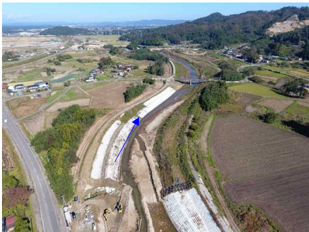
⑱阿武隈川水系内川流域築堤外(その11)工事 内川 河川土工 着手前 〈和田橋下流〉
