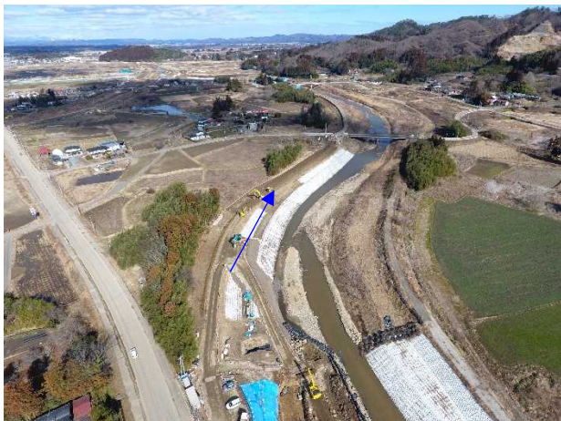
⑱阿武隈川水系内川流域築堤外(その11)工事 内川 河川土工 施工中 〈和田橋下流〉
