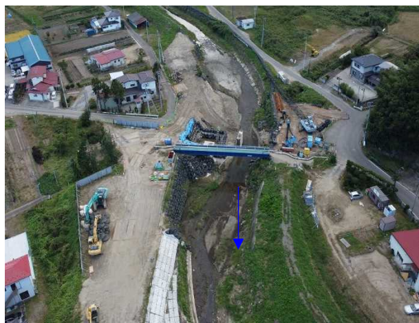
④内川流域橋梁下部工工事 旧五福谷橋 旧橋撤去工 施工中 〈旧五福谷橋上流〉
