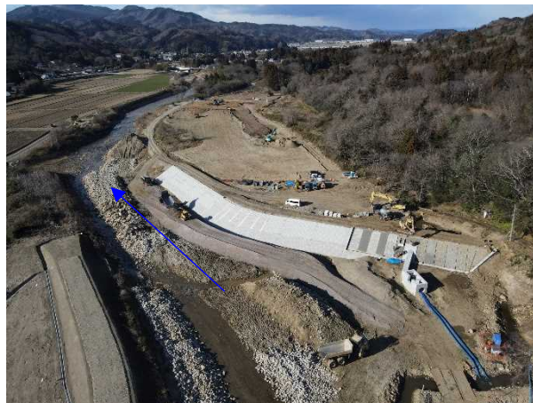
⑪阿武隈川水系内川流域築堤外(その3)工事 内川 法覆護岸工・導水路工 施工中 〈矢田橋上流〉
