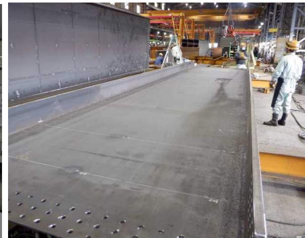
⑥内川流域下矢田橋上部工工事 下矢田橋 鋼橋架設工 組立て状況
