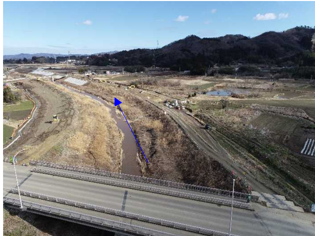
⑳阿武隈川水系内川流域築堤外(その12)工事 五福谷川 河川土工 施工中 〈五福谷川橋下流〉
