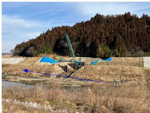
⑦内川流域災害復旧施設外(その2)工事 樋管④ 樋管本体工 着手前 〈内川橋下流〉
