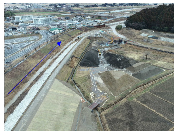
⑫阿武隈川水系内川流域築堤外(その4)工事 新川 河川土工 施工中 〈竹谷橋下流〉
