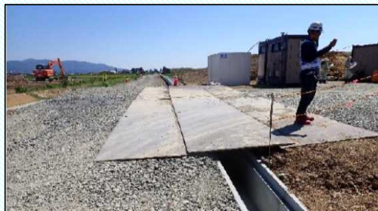
鉄板の段差表示が必要だと思われる
