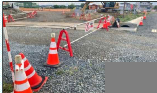
一般車両が通行する道路に面した場所に重点的に保安灯を設置した
