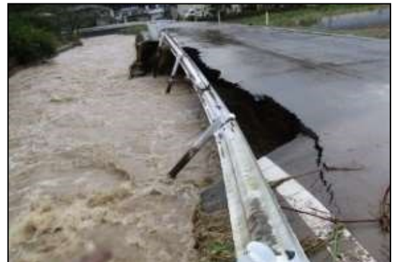
令和元年東日本台風（台風19号）による南沢川護岸および県道の崩壊状況（登米市）
