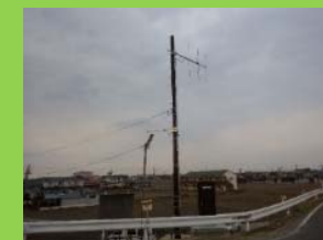
西荒井水位局設置状況
