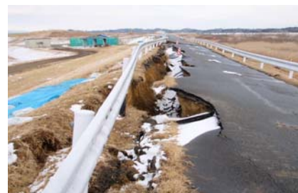
吉田川左岸 14.7k 地震による堤防天端クラック
