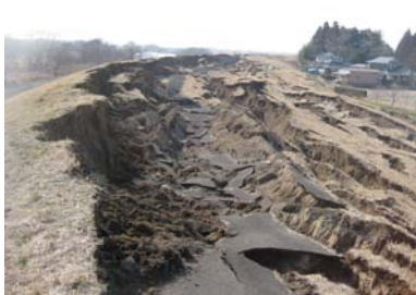
鳴瀬川左岸 30.3k 地震による堤防沈下
