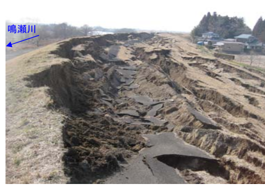
鳴瀬川左岸30.3k付近(大崎市古川) ※地震による堤防沈下
