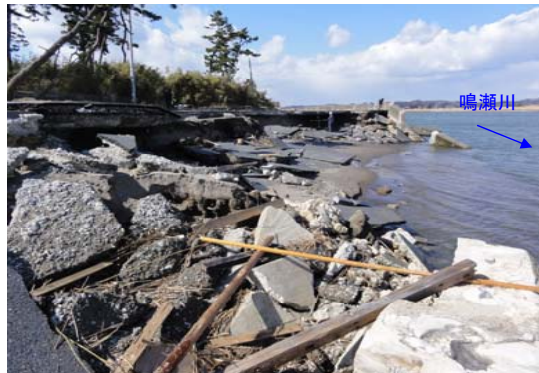
鳴瀬川右岸0.0k付近(東松島市野蒜) ※津波により堤防が流出
