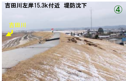
吉田川左岸15.3k付近 堤防沈下
