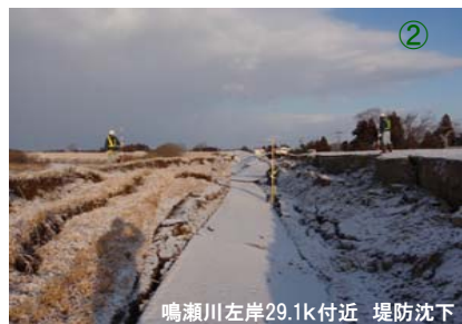
鳴瀬川左岸29.1k付近 堤防沈下
