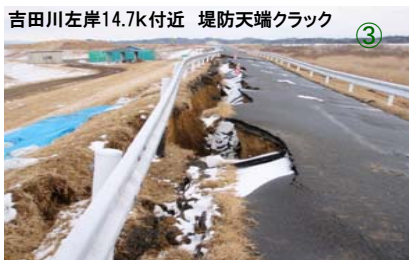
吉田川左岸14.7k付近 堤防天端クラック
