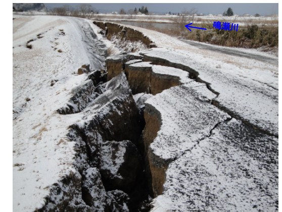
地震により天端沈下と縦断クラック発生 (鳴瀬川左岸11.4k付近 美里町二郷砂山地先)
