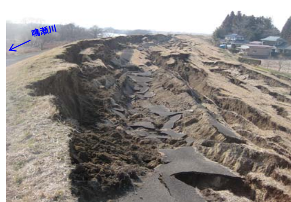
地震により堤体が崩落 (鳴瀬川左岸30.3k付近 大崎市古川下中目地先)
