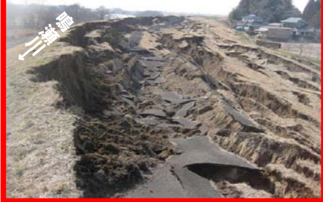
鳴瀬川(下中ノ目地区) 堤防被災状況
