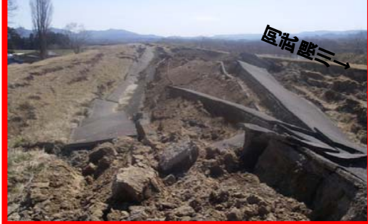
阿武隈川(枝野地区) 堤防被災状況
