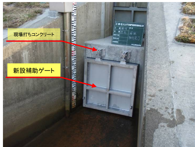
津波対策として人的操作が不要な補助ゲートの設置 (H19年度) 「原田排水樋管(吉田川右岸)」
