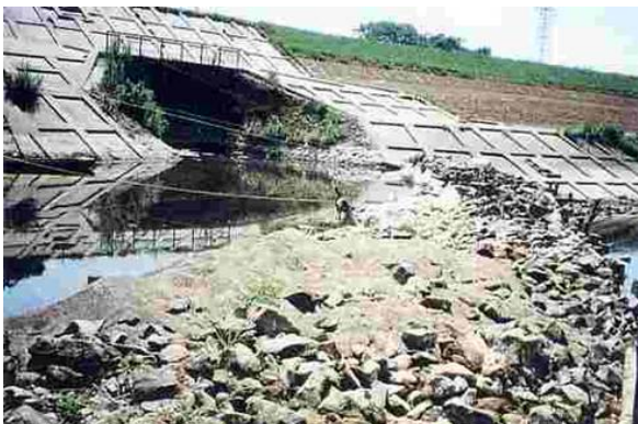
鳴瀬川中才揚水機場
