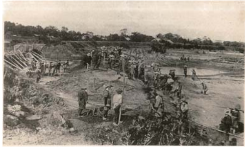
明治 43 年 8 月洪水 鳴瀬川旧三本木（大崎市）にて堤防決壊箇所を修復する様子
