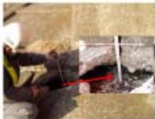
写真 3-5 堤防空洞化状況
