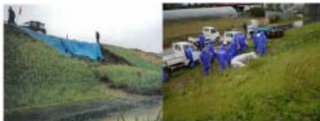
写真 3-2 堤防はなれた状況
