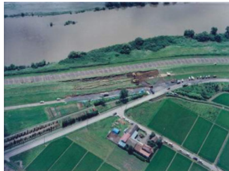
宮城県北部を震源とする地震による堤防の被災状況 (鳴瀬川右岸13km付近)
