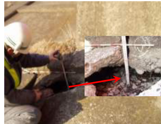
堤防の空洞化状況
