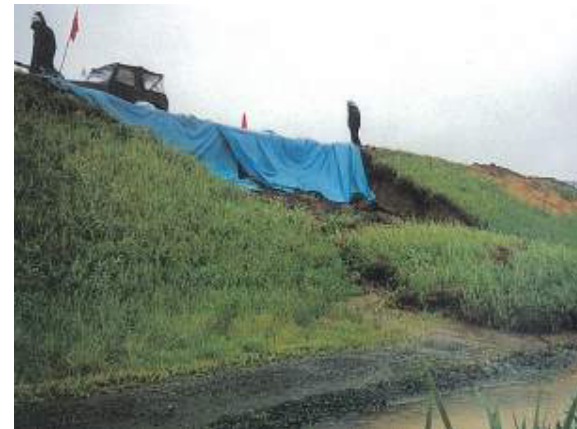
堤防法崩れの状況
