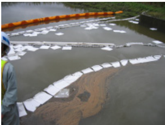
善川油流出対策状況
