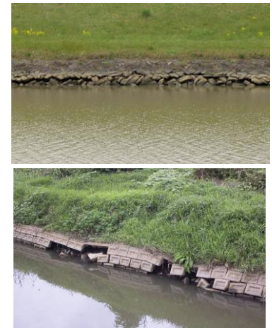
護岸の崩壊状況
