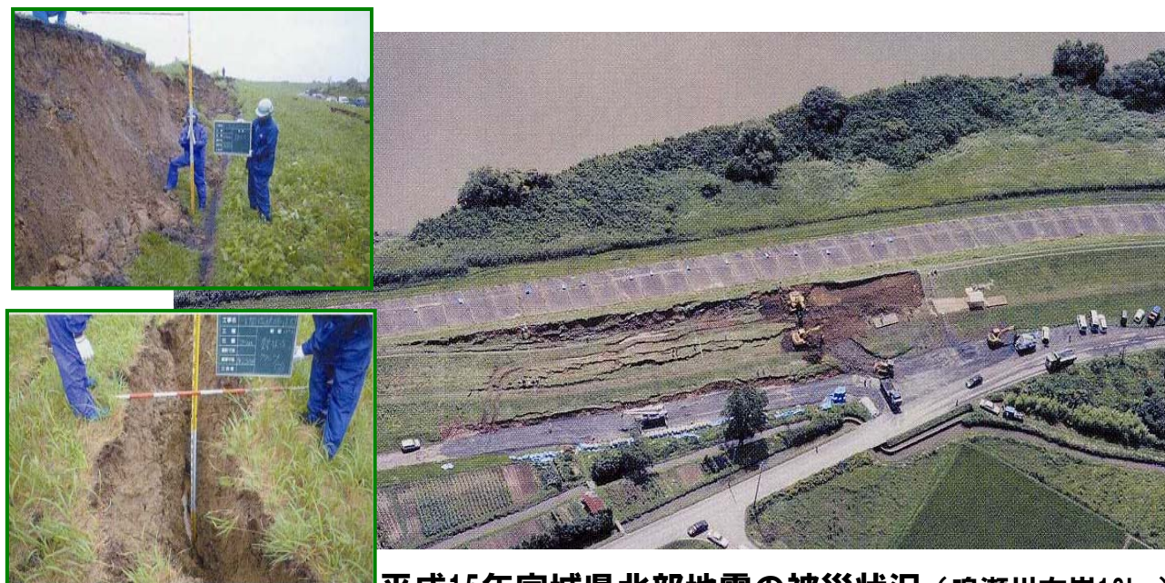
平成15年宮城県北部地震の被災状況(鳴瀬川右岸13km)
