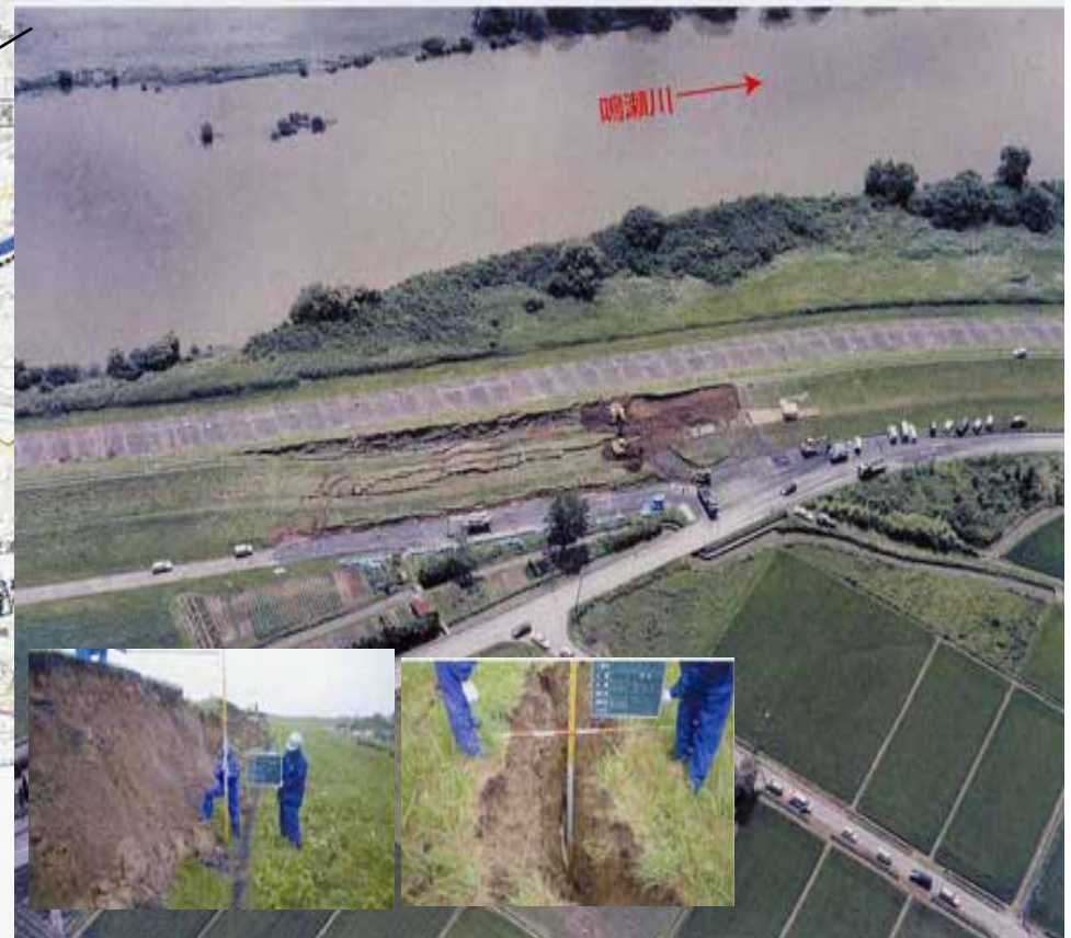
鹿島台町木間塚（鳴瀬川右岸13km付近）の状況
