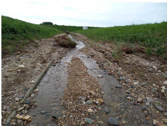
最上川右岸支川(山寺川)の被災状況
