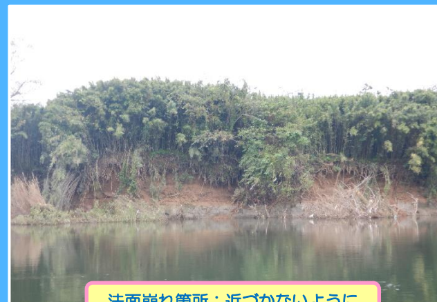
法面崩れ箇所：近づかないように
