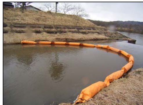
※H22年3月 オイルフェンス設置状況
