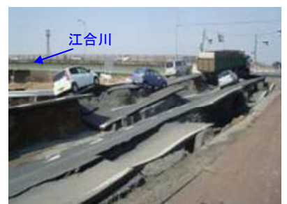
江合川左岸27.6k付近 (大崎市古川瀨尻地先) ※地震により縦断クラック発生
