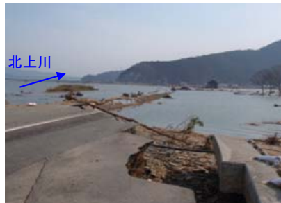
北上川右岸4.0k付近(石巻市針岡地先) ※津波により堤防が流出
