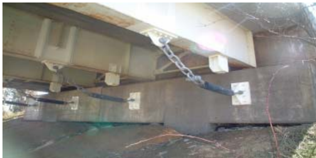
橋梁震災対策（落橋防止装置）の設置例
