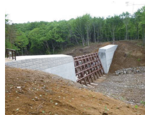
土石流発生前（H24年6月）
