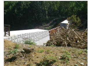
土石流発生後（H25年9月17日）
