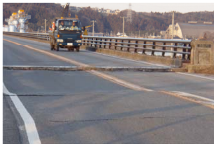
▲東日本大震災直後の鮫川大橋の被災状況
