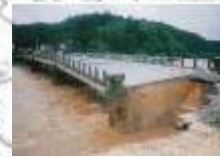
橋台が河川の浸食により下がった県道白河・羽鳥線の羽太橋(西郷村)
