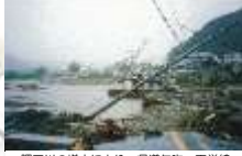
浪戸川の増水により、県道失効・天栄線の路面が崩壊(白河市(旧大徳村))
