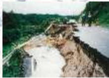
広城農道が約100mにわたり崩壊(西郷村)
