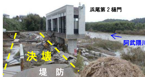
98.6k 左岸堤防決壊箇所(須賀川市)
