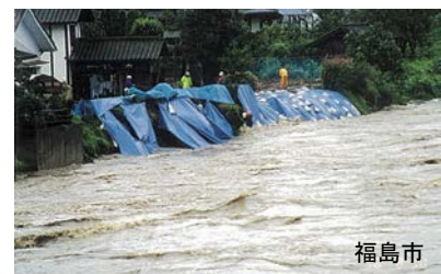
平成10年8月洪水の被害状況
