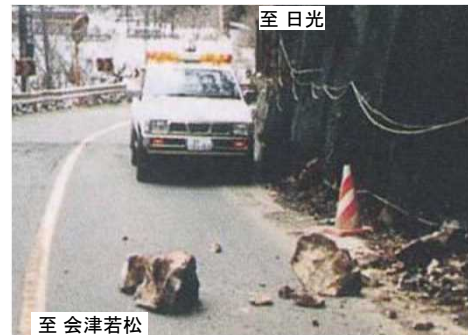
▲国道121号の落石状況
