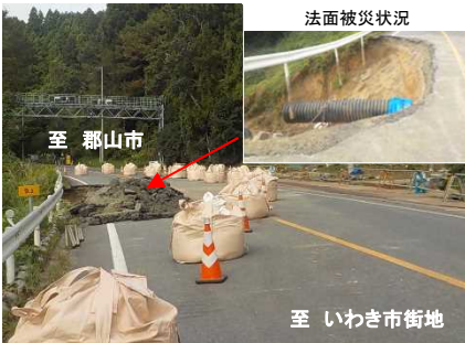
▲大雨により路肩法面が崩壊
