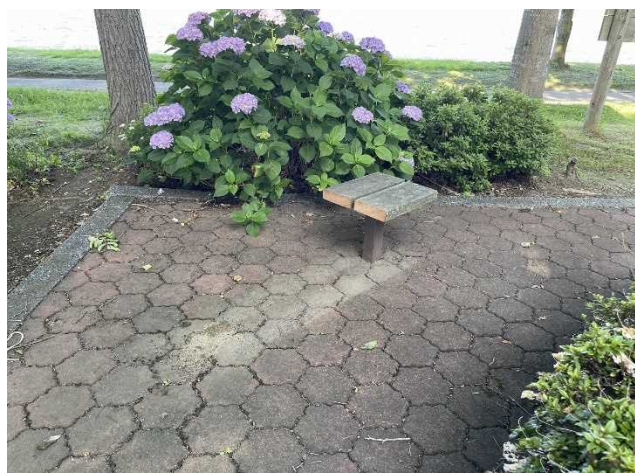
不具合箇所(ベンチの脚腐食) 腐食部分撤去済み
