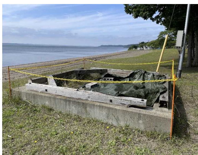
不具合箇所(漁具の散乱)格納及びチェーンの取付け
